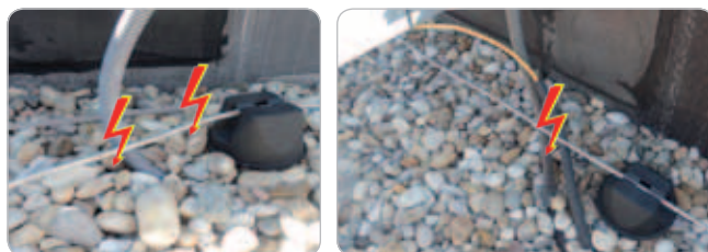
Obr. 5 a 6 Skrytý svod umístěný v hořlavé instalační trubce/ přeskok blesku na vnitřní instalace kovovou konstrukcí na střeše objektu
