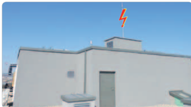
Obr. 2 Jímač ESE na střeše multifunkčního objektu
