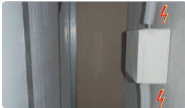
Obr. 9 a 10 Nepřístupné zkušební svorky/ skryté svody umístěné v hořlavých trubkách
